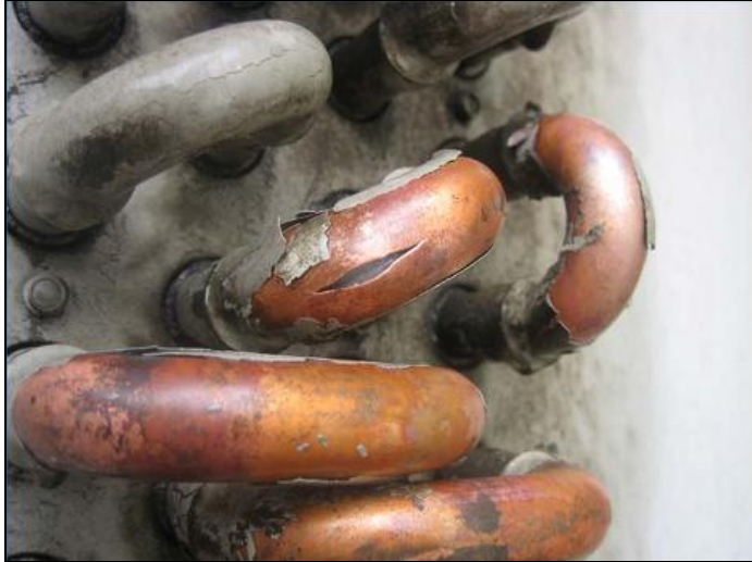
Şekil 1. Donma sonucu Radyatör borularında meydana gelen tipik bir hasar [1]
