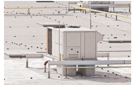
Şekil 1. Çatı tipi klima ünitelerin yaygın uygulama biçimi [2]
